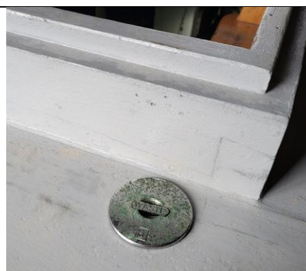
Figur 2 Tømningsventil findes ved nedgang til maskine
